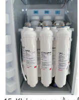
15. Khóa van nguồn cấp nước và tắt nguồn điện.
