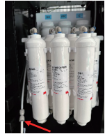
14. Nối ống nhựa PE và mở nguồn nước và điện. Hãy để nước chảy ra liên tục khoảng 10 phút.
