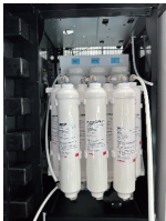
21. Mở nguồn cấp nước. Rửa bộ lọc trong khoảng 10 phút.
